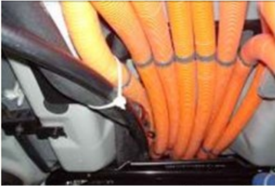
Καλωδίωση υψηλής τάσης
